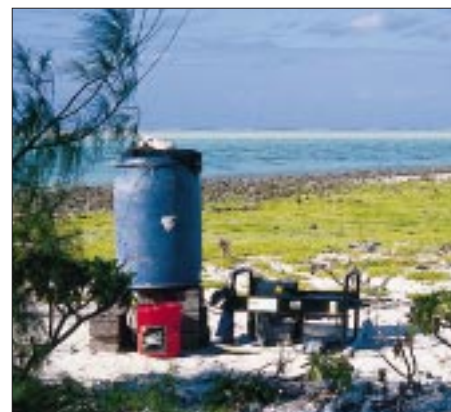
Der Generator. Das blaue Faß ersetzte den Tank, was einen unterbrechungsfreien Betrieb von 11 Tagen ermöglichte.
